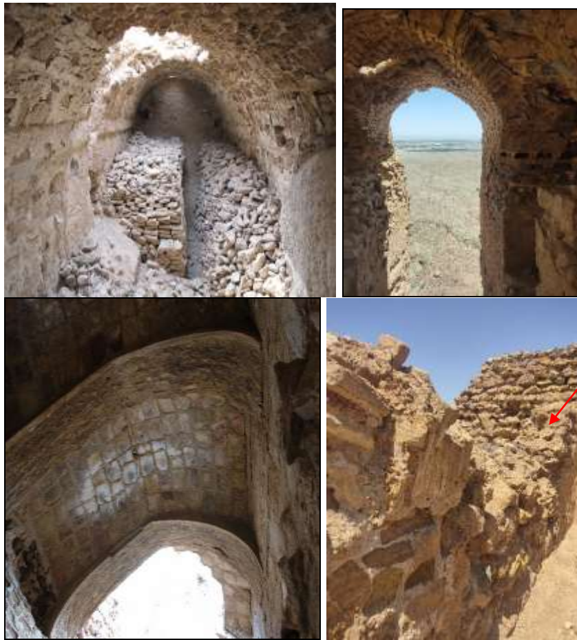
تصاویر ۱۹، ۲۰، ۲۱ و ۲۲: اجرای قوس جناقی و اجرکاری خفته راسته در درگاه غربی شاه نشین. نحوه اجرای طاق بیز (گهواره‌ای) در فضاهای زیرین شاه‌نشین. پایه تویزه باقی مانده دریکی از فضاهای زیرین شاه‌نشین. اجرای طاق و چشمه و طاق لاپوش اتاقدک واقع در راه پله شمالی (عکس از نگارندگان)
